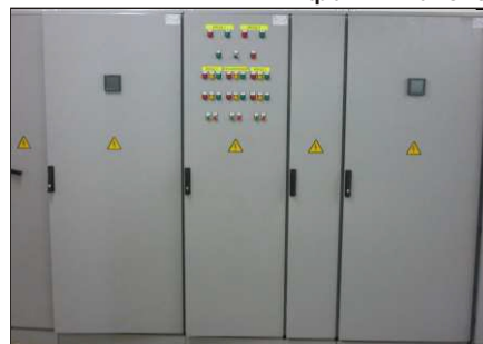
Объединение шкафов в линейку
