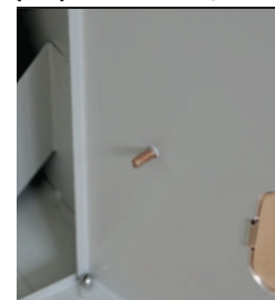
Все элементы имеют шпильки заземления
