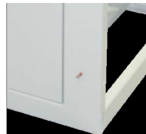
Заземление на фасаде корпуса
