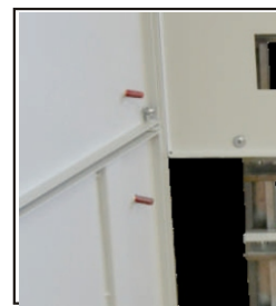
Элементы заземления на дверцах
